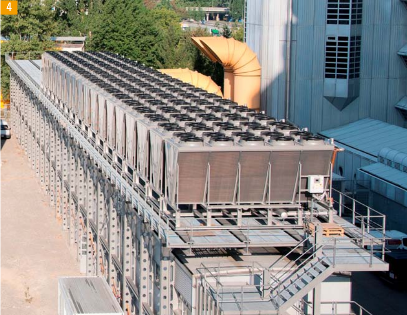
Freecooling-Anlage als Alternative zu stromfressenden Klimaanlage.
