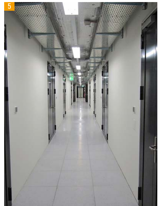
Individuell abgesicherter Zugang zu privaten Räumen («Private Room»).
