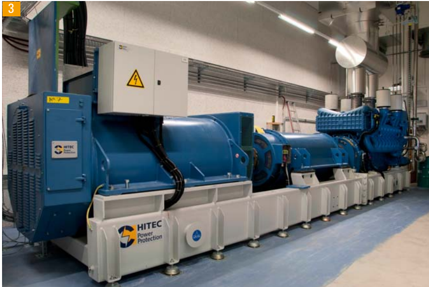
Unterbrechungsfreie Stromversorgung mit «No break»-Anlage.
